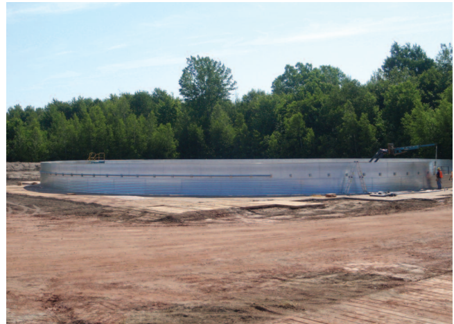
Construction d'un conteneur conçu spécialement pour les opérations de la fracturation hydraulique.
